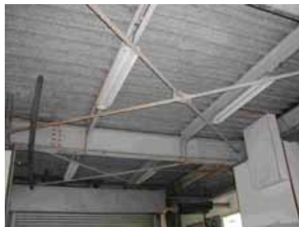
(建物天井への飛散性吹き付け石綿の状況)
