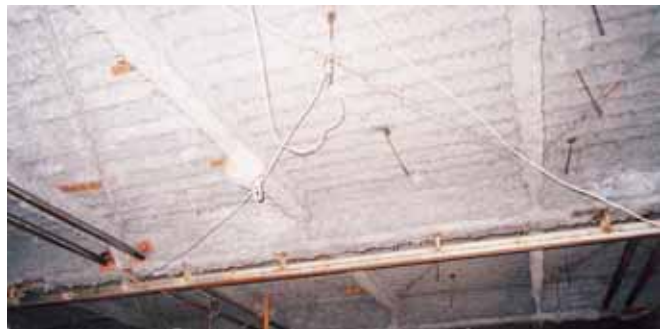
(天井への吹き付け石綿の劣化状況)
