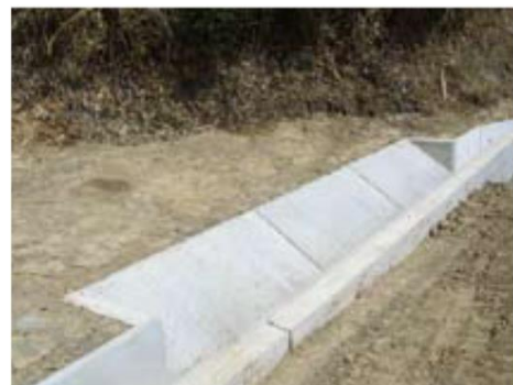
スロープ付き側溝
