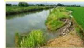
法面の浸食と農地被害
