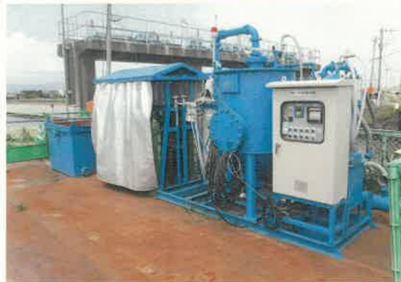
中和処理施設の設置
