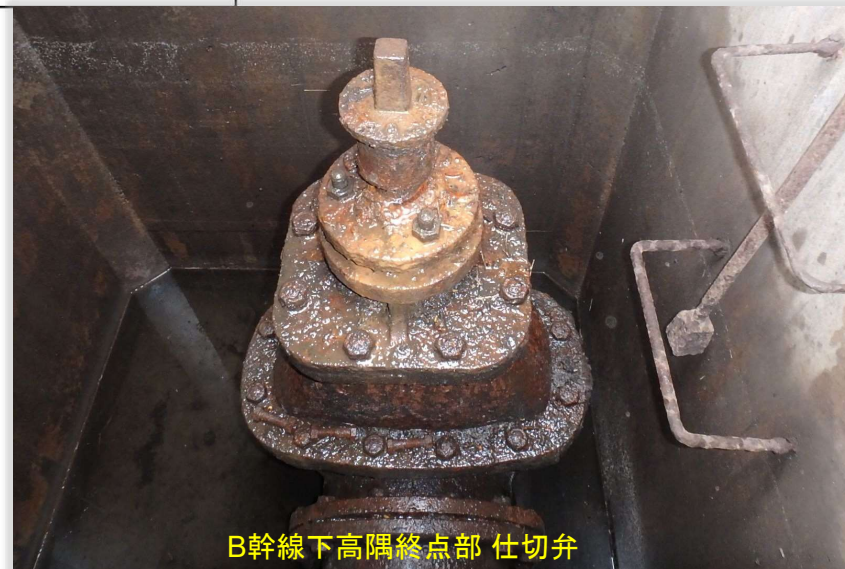
仕切弁の老朽化
