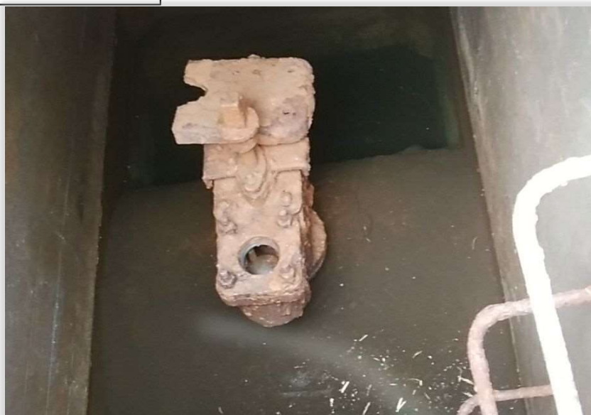
制水弁の老朽化
