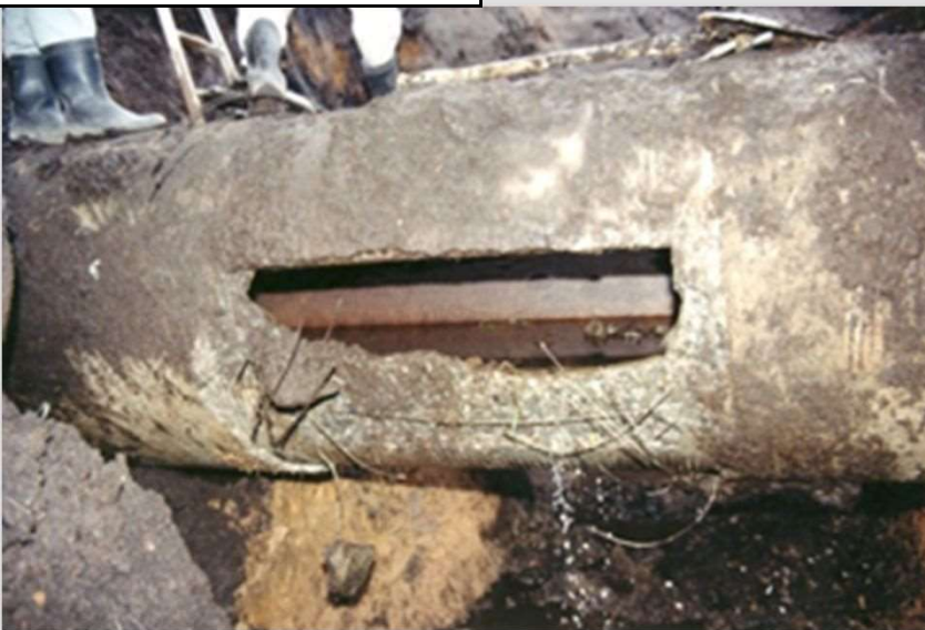
老朽化による管体破損（E幹線水路）
