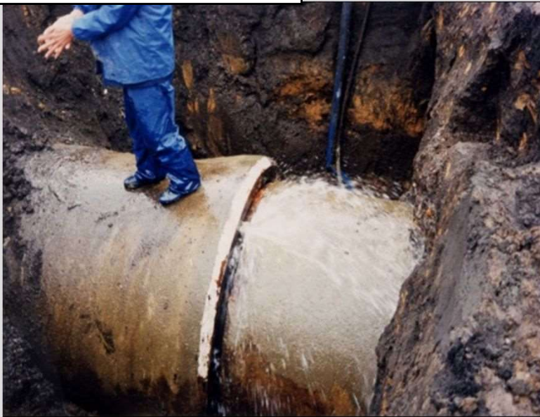
継ぎ手からの漏水（F幹線水路）
