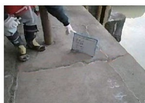
コンクリート構造物のひび割れ
