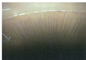
管頂亀裂発生(黒線部)
