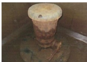
空気弁発錆による作動不良
