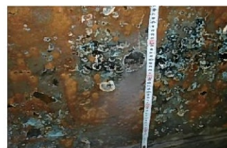
扉体表面の腐食
