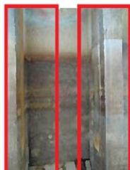
主ローラ作動不良による戸当りの損傷・発錆
