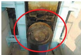
主ローラの作動不良と腐食
