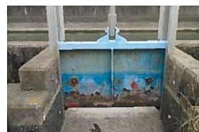
扉体の腐食・孔食
