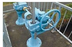
開閉装置のブレーキ故障
