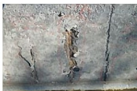
鉄筋の露出・錆
