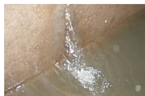
サイホン継手部での漏水
