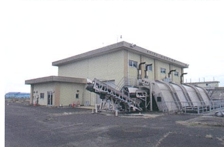
谷垣排水機場
