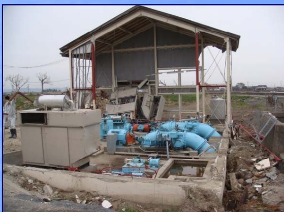
津波で建屋が崩壊した排水機場
