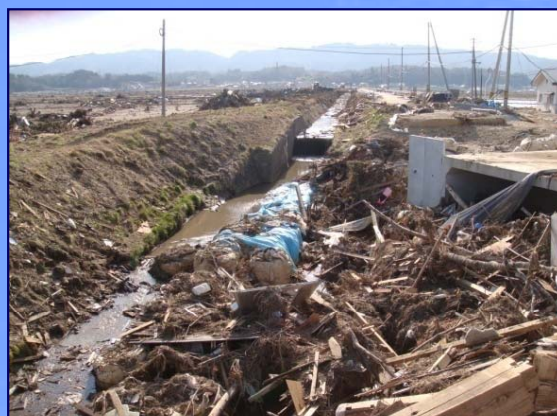
瓦礫が堆積した排水路
