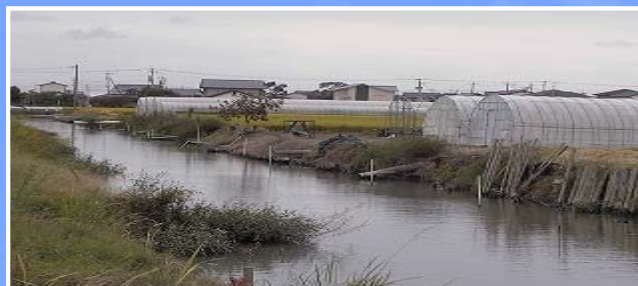
農業用ハウス付近のクリーク法面崩壊状況
