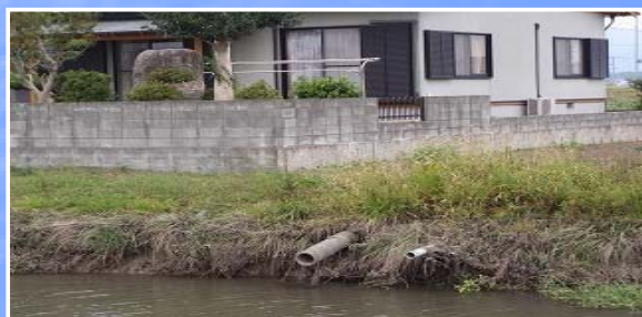
家屋周辺のクリーク法面崩壊状況
