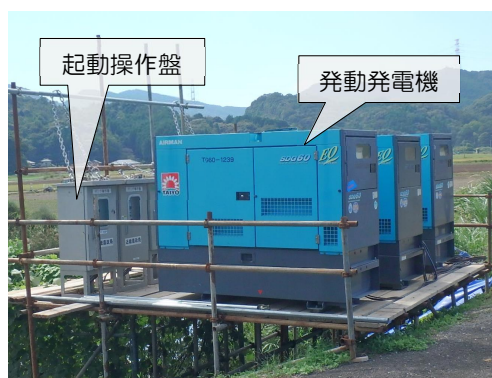
起動操作盤と発電発電機
