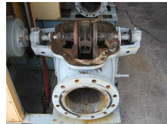
工場で修理中のポンプ
