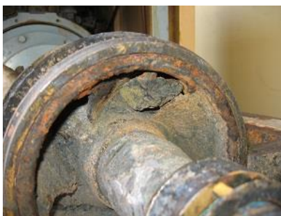
石の噛み込み
