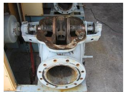
工場で修理中のポンプ
