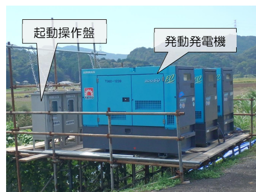
起動操作盤と発動発電機
