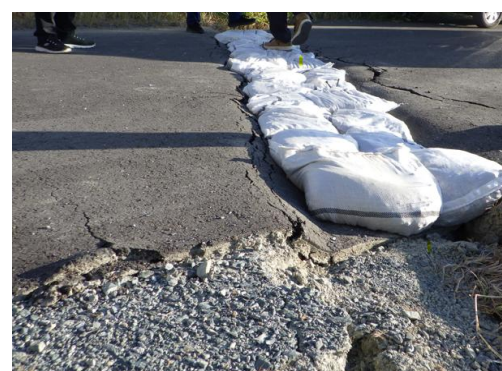
道路陥没に対する緊急対応
