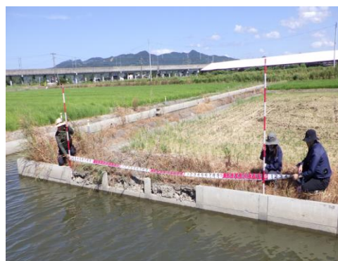
コンクリート柵渠の破損状況
