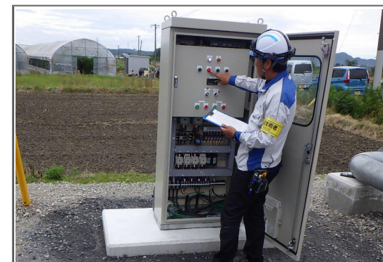
ポンプ操作盤 (南豊崎1号)
