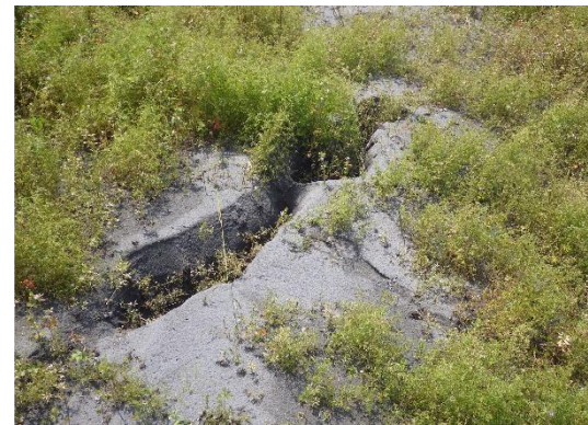
昭和海岸の堤防の被災状況
