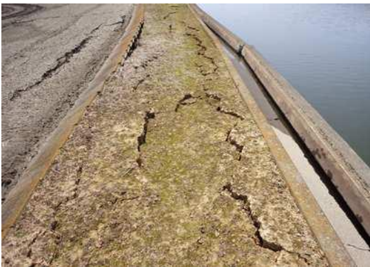
郡築海岸の堤防の被災状況
