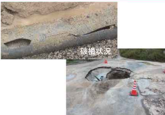
用水路の破損、漏水による道路の陥没
