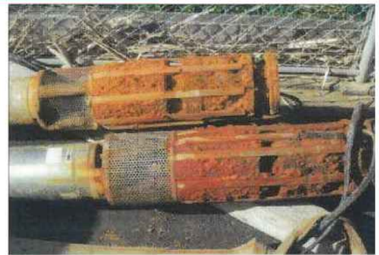
取水ポンプの発錆
