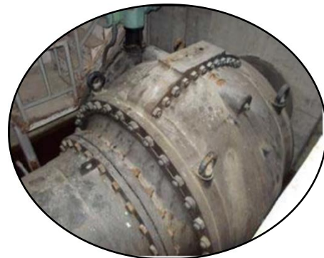
すぎやす 杉安取水工 バルブの老朽化
