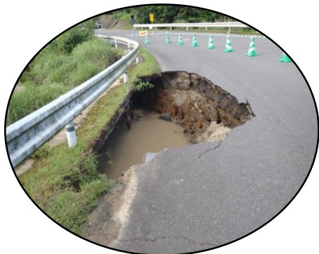
幹線水路 漏水事故
