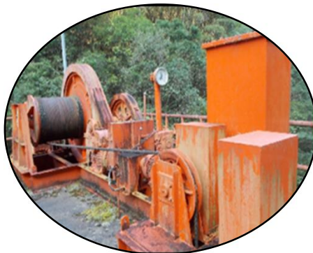
せこがわ 瀬江川頭首工 の老朽化
