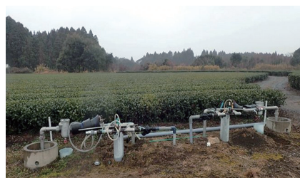
茶園（手前の施設は液肥混入器）
