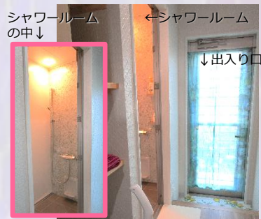
作業後すぐに利用できるよう出入り口近くに設置されたシャワールーム
