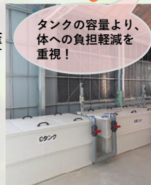
肥料タンク、肥料プールを屋内に設置。雨の日もぬれずに作業が可能。
