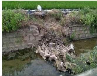
水路の損壊 (氷川町)
