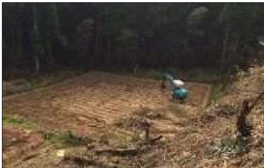
農閑期 バックホーによる表面排水処理 バックホーによる地表排水処理の施工
