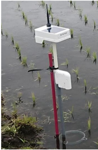
水位計測装置 (太陽光発電)
