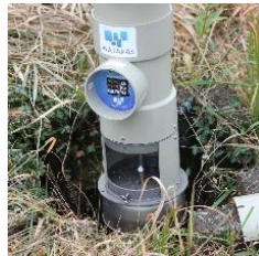
自動・遠隔操作水管理システム
