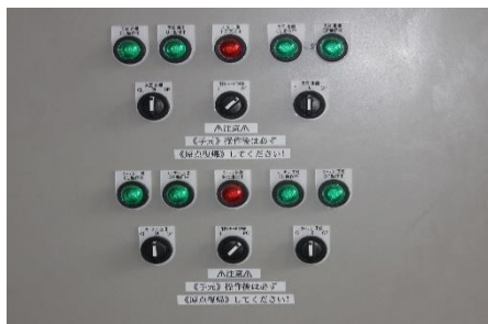
【制御装置(一部)】
