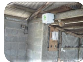
監視カメラ(移設可能タイプ)
