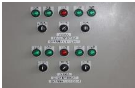
【制御装置(一部)】
