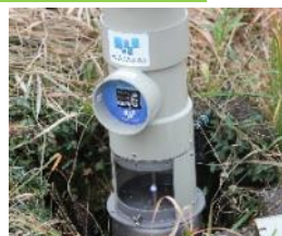
自動・遠隔操作 水管理システム
