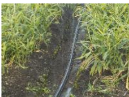
ほ場散水パイプ
