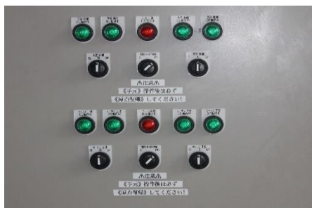
【制御装置(一部)】
