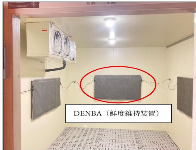
保冷保存倉庫内のDENBA
