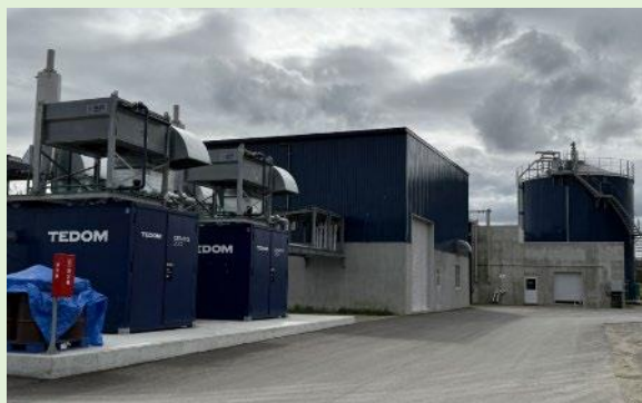
完成したバイオガスプラント
