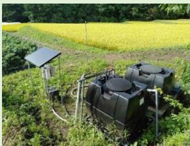
ソーラーパルサーE（蓄電式ソーラー自動かん水システム）の設置状況
