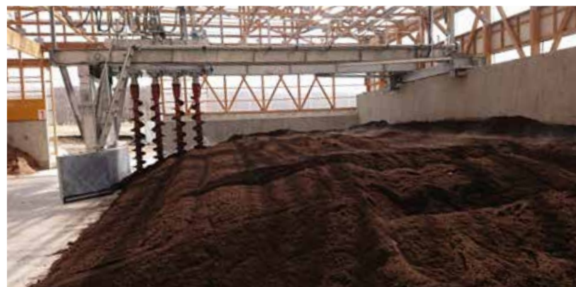
堆肥原料の自動攪拌機
