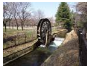
農業用水路に設置さ れた小水力発電施設
