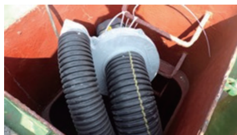
エスケープホールに設置されたパイプとブロー
