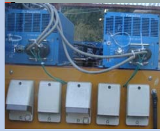
④インバーター容量 約7.5[kW] (3kw×2基, 1.5kW×1基)
