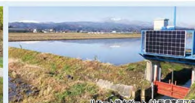
リモート排水ゲート（山形県寒河江市）
