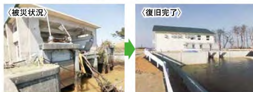
【▲高砂南部排水機場】
