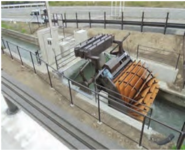
農業水利施設を活用した小水力発電の導入
