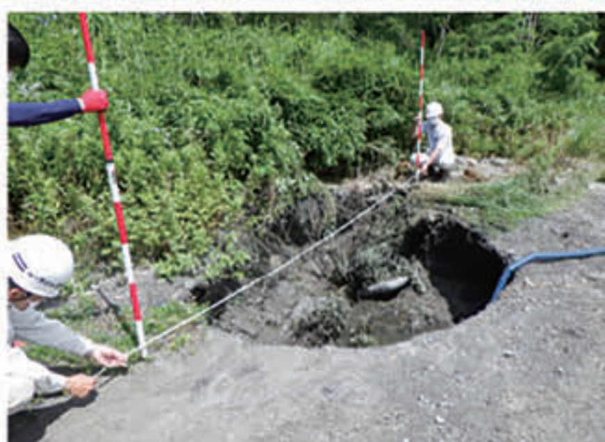
▲道路下に埋設された幹線用水路からの漏水に伴う土砂流出等による道路陥没が発生 【令和3年2月】
