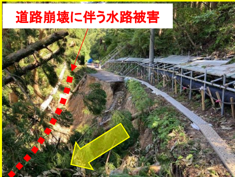
道路崩壊に伴う水路被害
