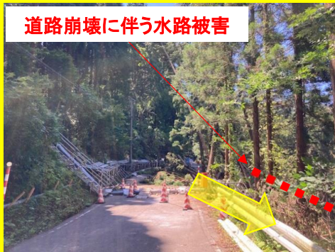
道路崩壊に伴う水路被害
