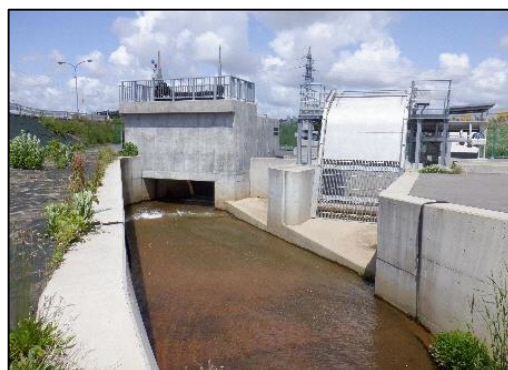
排水機（令和 4 年度完成）
