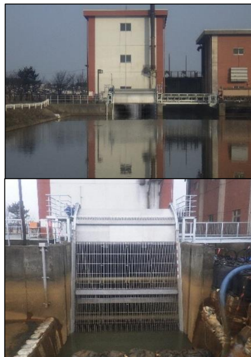
除塵機新設（令和 4 年度完成）
