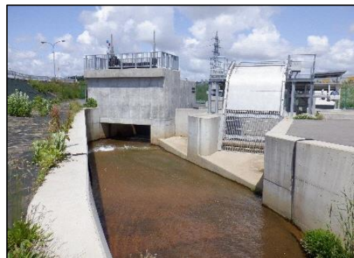
排水機（令和 4 年度完成）
