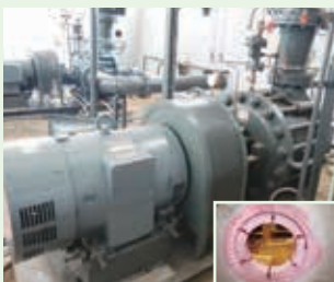
ポンプ部品の破損
