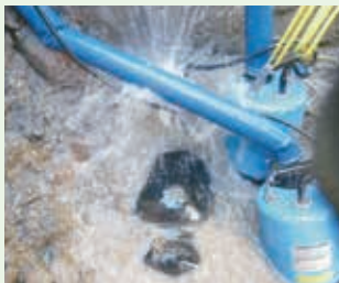
鋼管の腐食による 漏水事故
