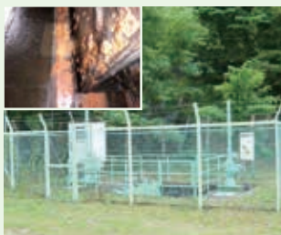
導水トンネル (呑口ゲートの腐食)
