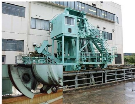
除塵設備（車輪破損）
