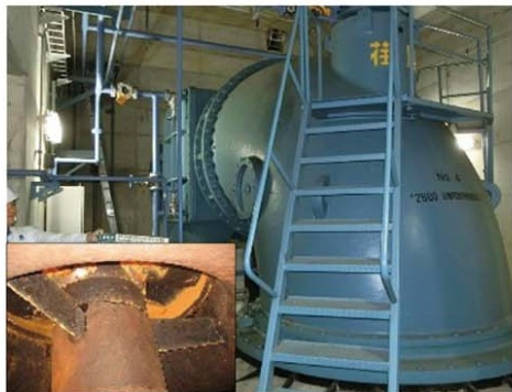
ポンプ設備（ポンプ内部腐食）
