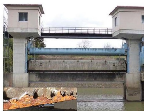
制水門（門扉腐食）
