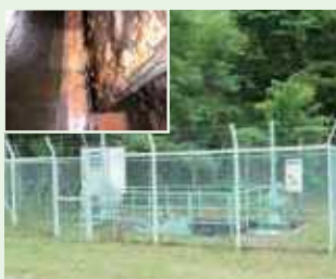
導水トンネル (呑口ゲートの腐食)
