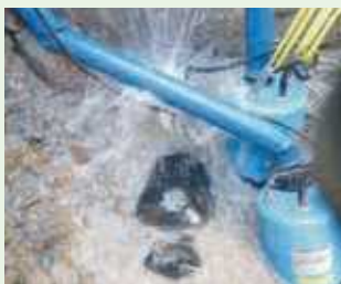
鋼管の腐食による 漏水事故
