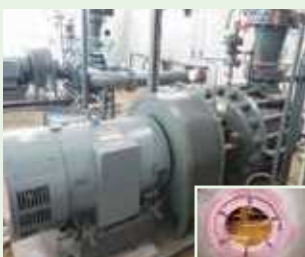
ポンプ部品の破損
