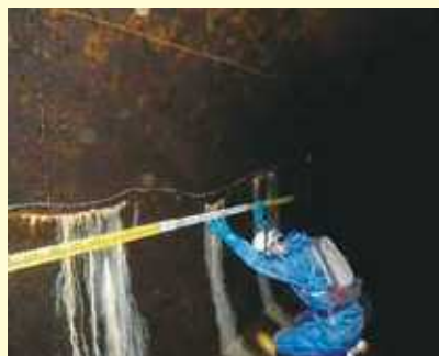
【北幹線用水路】 トンネル内縦断クラック
