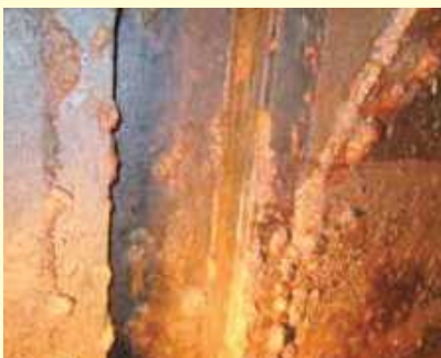
【導水トンネル(南北調整池)】 北幹線ゲート戸当たり発錆
