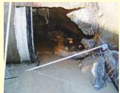
【南幹線用水路】 PC管破損状況
