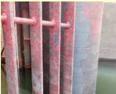
【千五沢ダムかんがい用取水施設】 スクリーン塗装劣化
