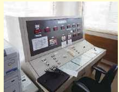
【取水施設遠方操作設備】 操作卓（耐用年数超過）
