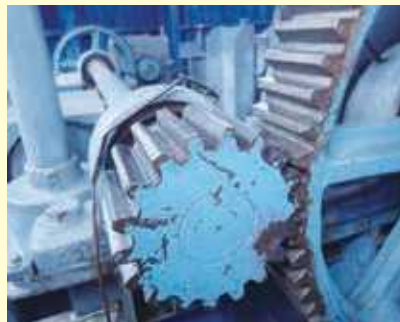
【千五沢ダムかんがい用取水施設】 開閉装置歯当たり不良
