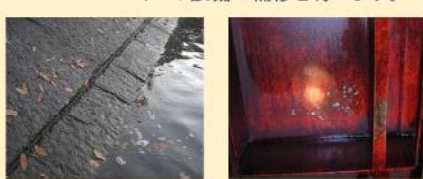
【固定堰】 摩耗により鉄筋露出 【ゲート設備】 表面劣化
