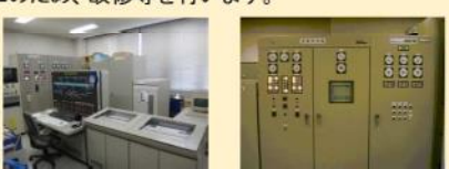
【操作卓】 【遠隔操作盤】
