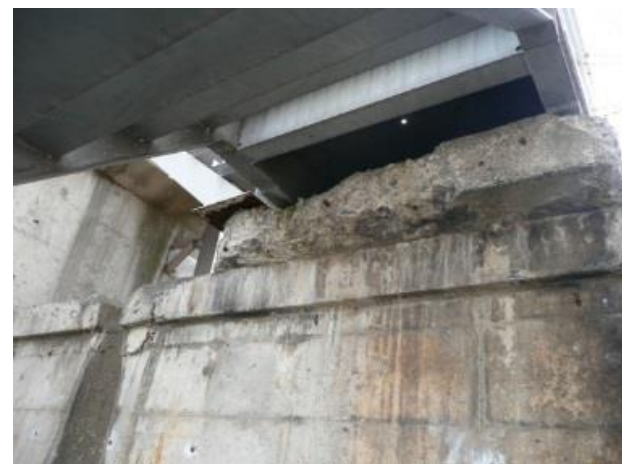
赤川頭首工 堤体コンクリートの欠損
