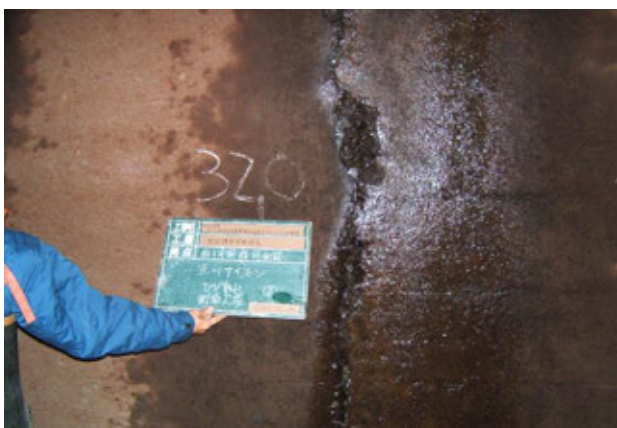
赤川サイホン ひび割れ・漏水
