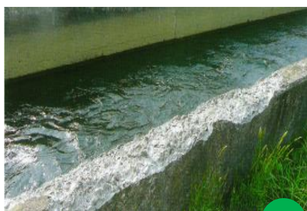
凍結による水路側壁の欠損
