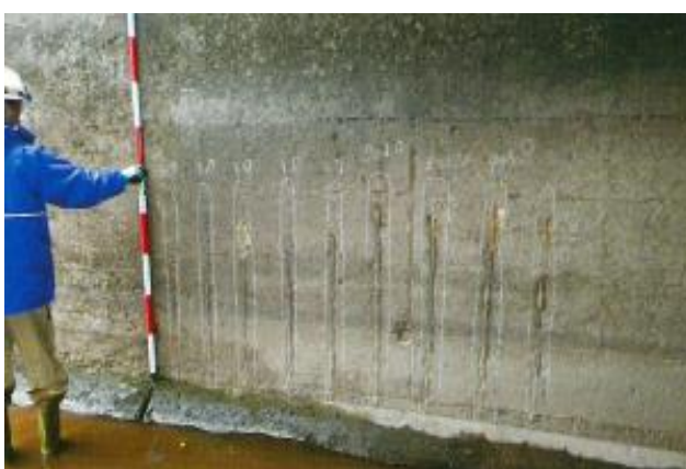
幹線用水路 側壁の鉄筋露出
