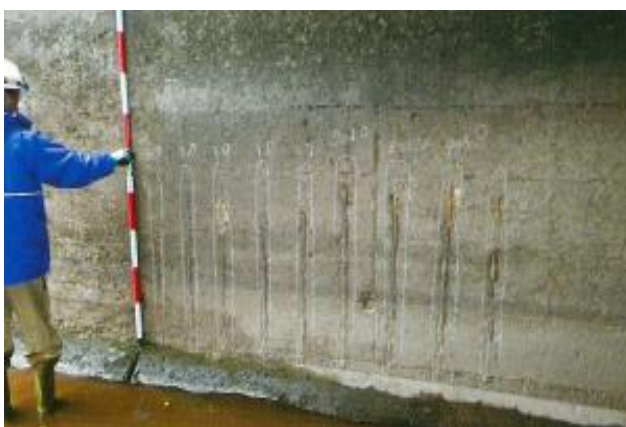
幹線用水路 側壁の鉄筋露出
