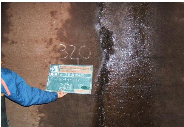
赤川サイホン ひび割れ・漏水
