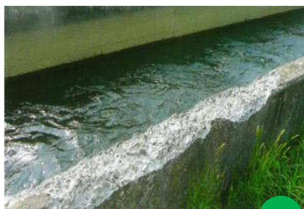
凍結による水路側壁の欠損
