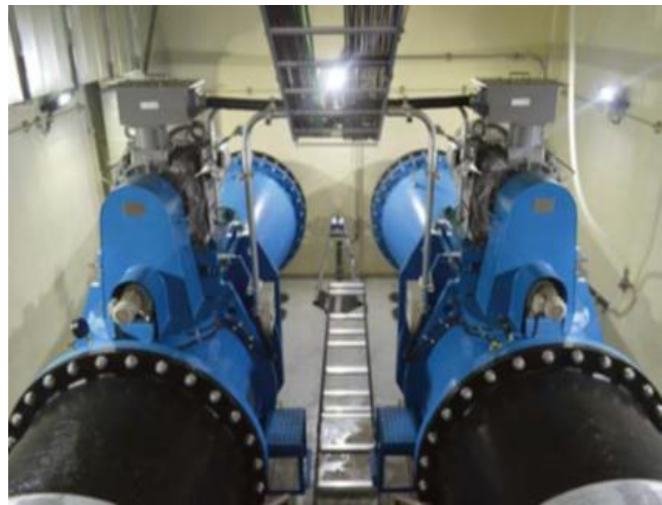
小水力発電設備
