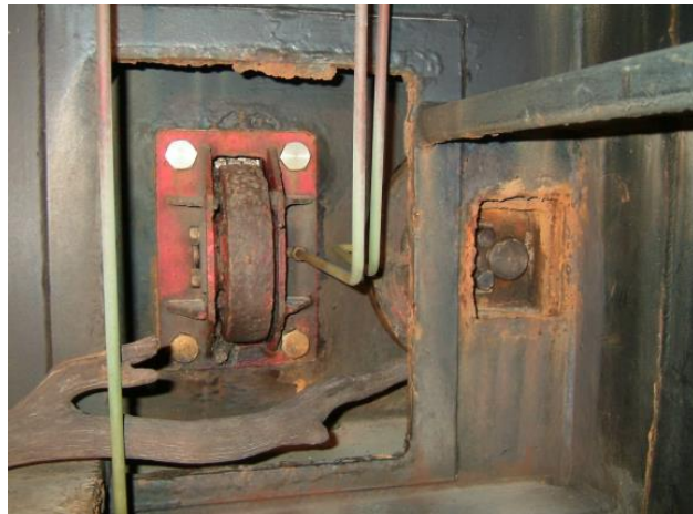
赤川頭首工 ゲートサイドローラー老朽化
