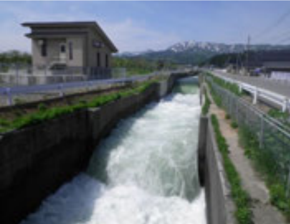
赤川地区小水力発電所と西1号幹線用水路
