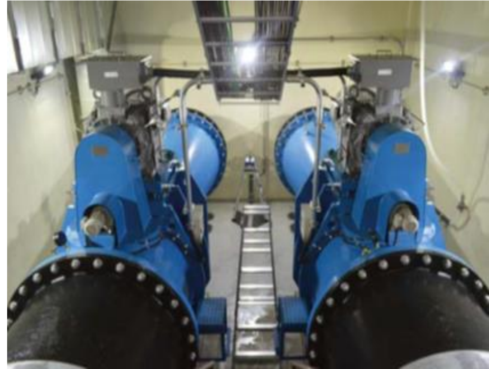
小水力発電設備
