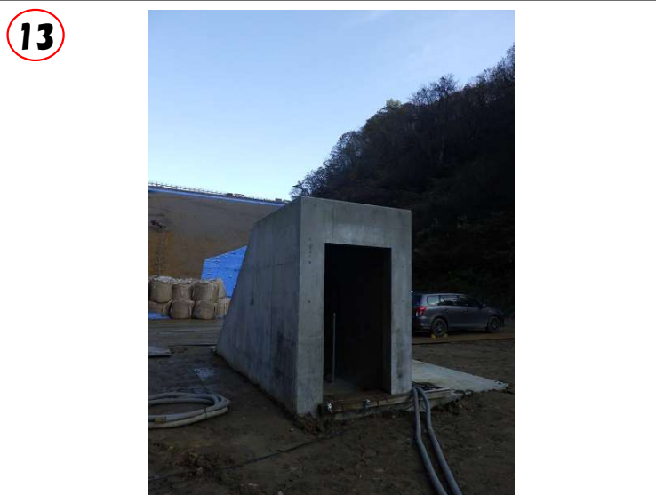
⑬堤体下流に設置した浸透量観測施設 (R5.11.16撮影)
