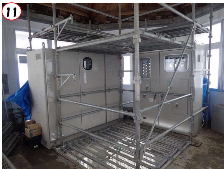
⑪取水塔上部に設置した機側操作盤 (R5.11.30撮影)
