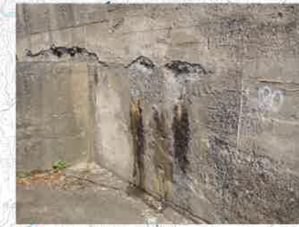
A 岩洞ダム洪水時劣化状況
