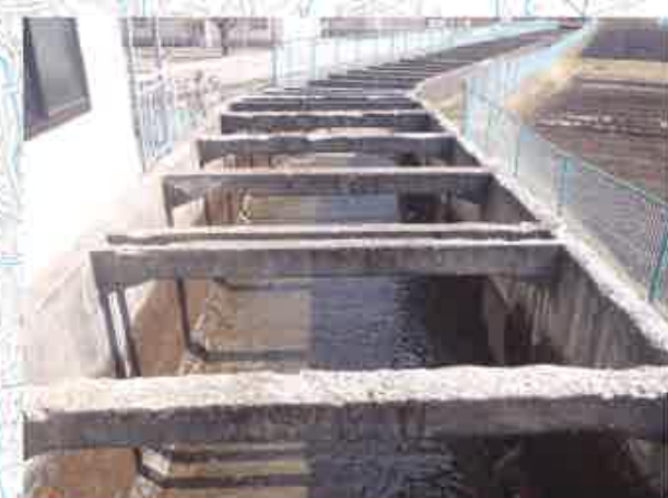
F 南部主幹線用水路 老朽化状況
